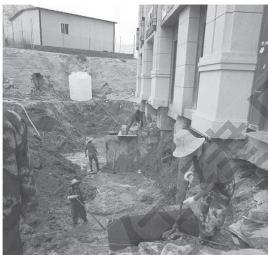
图 5-1 地基湿陷导致桩基被拉断
